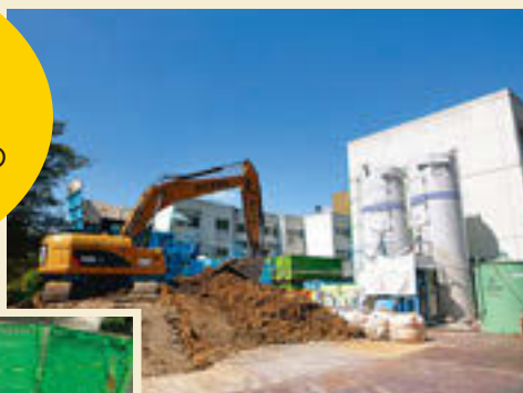
充填剤製造プラント
