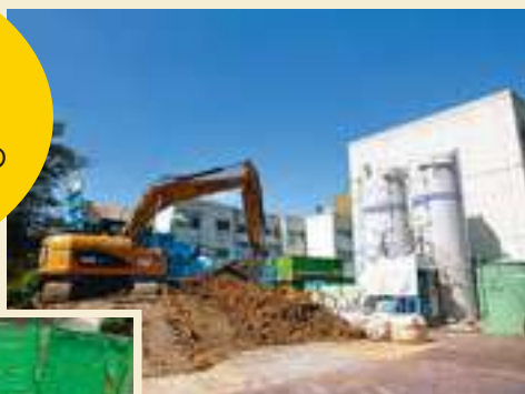
充填剤製造プラント
