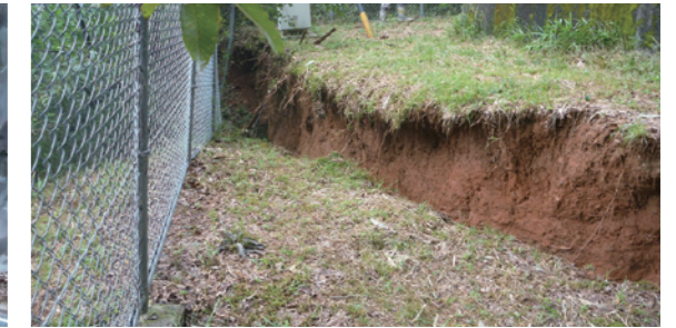
板良配水地(地すべり)
