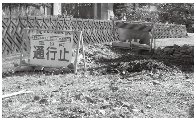
通行止めの現状
