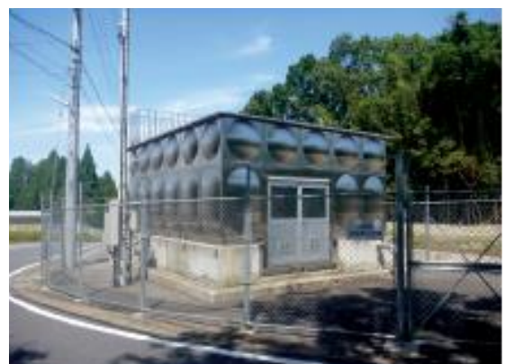
水道施設の計画的な更新(共和台加圧ポンプ場)
