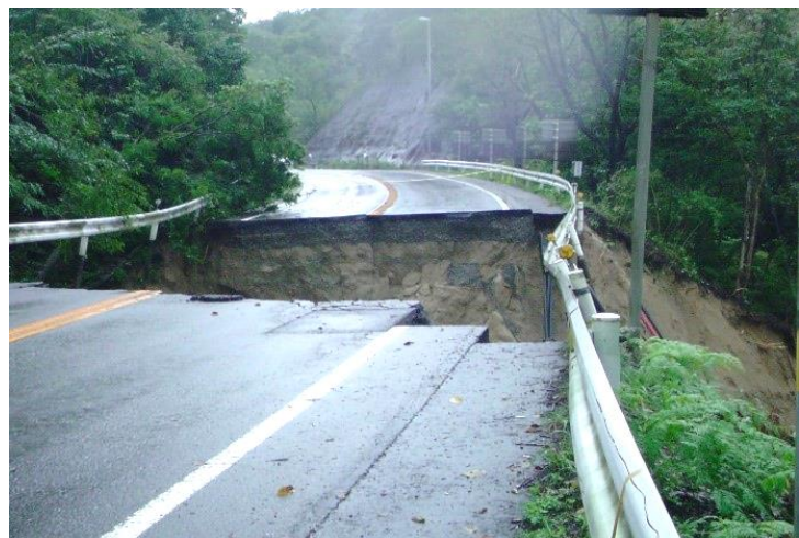
豪雨による国道の崩落(次月地内)
