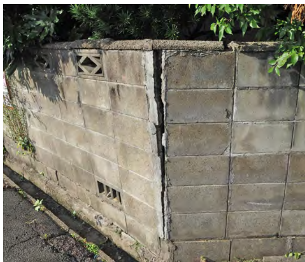
▲亀裂が入り倒壊の危険があるブロック塀
