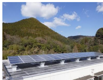
■太陽光発電設備（向陽中学校）
