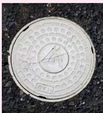
▲割れた公共汚水ますの蓋
