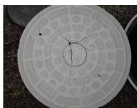
▲割れてしまった公共汚水ますの蓋
