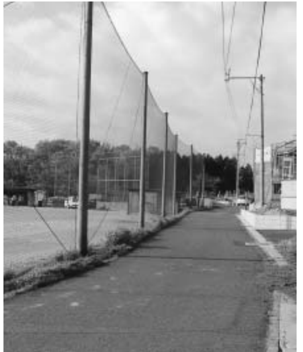
防球ネットの嵩上げが望まれる伏見グラウンド
