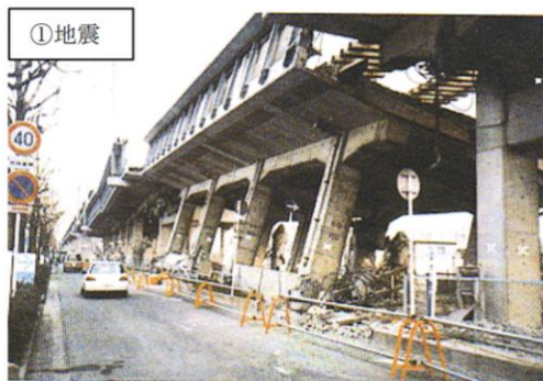
平成 7 年阪神・淡路大震災（山陽新幹線高架橋が倒壊）
