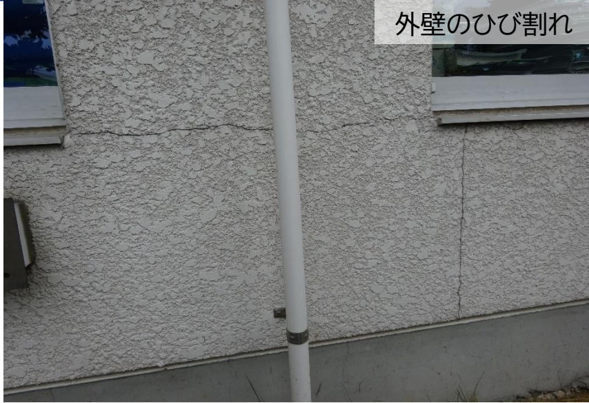
外壁のひび割れ
