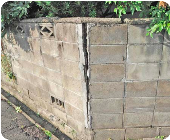
亀裂が入り倒壊の危険があるブロック塀
