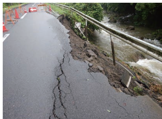
▶土砂崩れにより路肩が崩壊した道路（上之郷地内）
