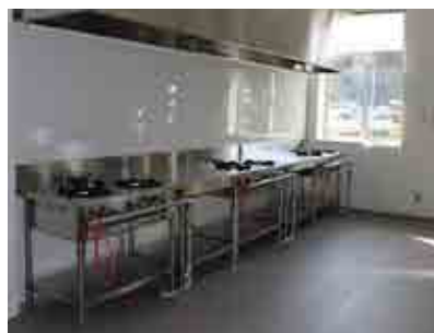
▲ 厨房…屋内の炊き出し機能として3台の大口コンロを配備
