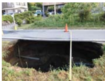
▲ 昨年5月12日に発生した町 道陥没被害の様子 （比衣地内）
