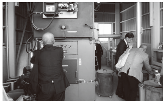
スイス製木質バイオマスボイラー
