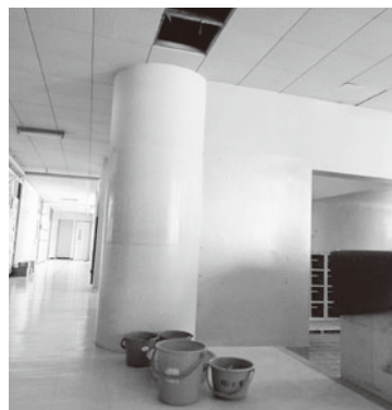
雨漏りがひどい南舎！ 早めの修繕が待たれます
