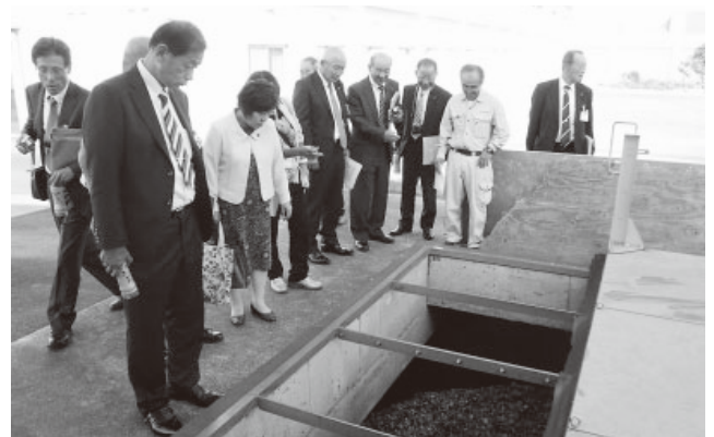
ウッドチップを自動でボイラーへ
