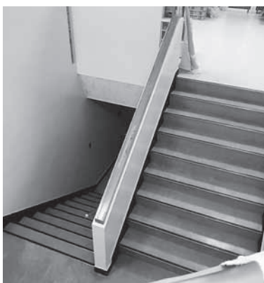
味噌運搬の妨げになっている階段
